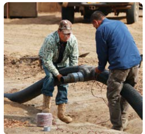
Rigoberto Elías y Austreberto Magaña trabajan para instalar nuevas líneas de drenaje en el aserrín.
