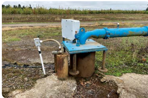
Ejemplo de cabezal de pozo para bomba sumergible. Tanto la bomba como el motor eléctrico se encuentran dentro del pozo.
